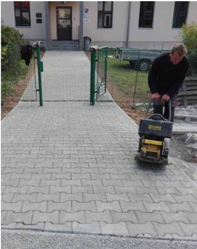
Zaměstnanec Obecního úřadu dokončuje práce na chodníku ke vstupu do školky v Kněhyních.
